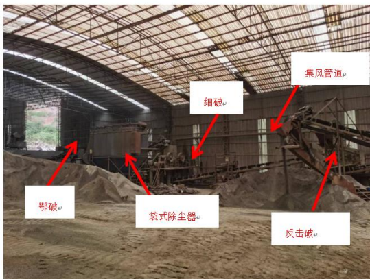
破碎车间主要生产设施及废气治理设施
